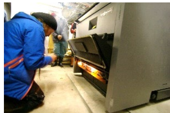
▲町内で導入された薪ボイラー
