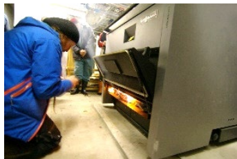
▲町内で導入された薪ボイラー
